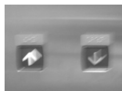
写真3：エレベーター内のボタン
